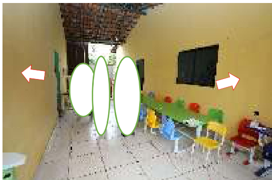
Figura 22 – Ausência de extintor no anexo da escola.
