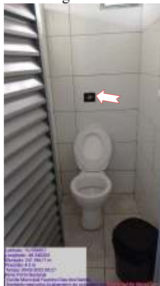
Figura 44 – Ausência de acabamento no acionador de descarga.
