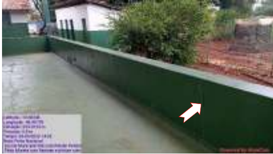
Figura 11 – Mureta com fissura.
