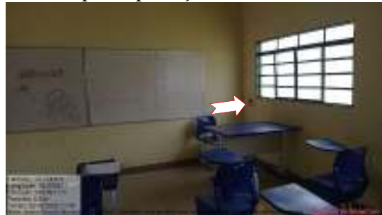
Figura 10 – Anexo - Interruptor elétrico sem tampa de proteção.
