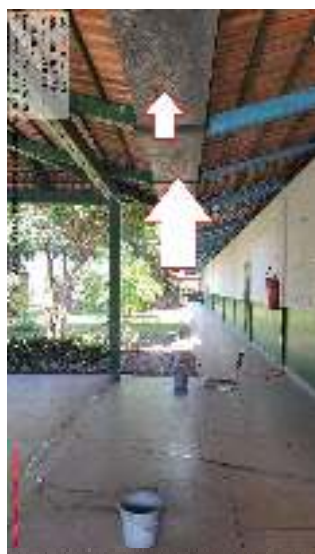
Figura 04 - Vazamento na calha metálica.
