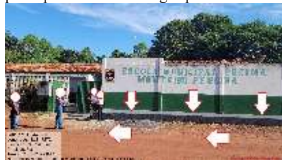
Figura 31 - Falta de piso tátil no acesso principal da escola e vagas pra idoso/PNE.
