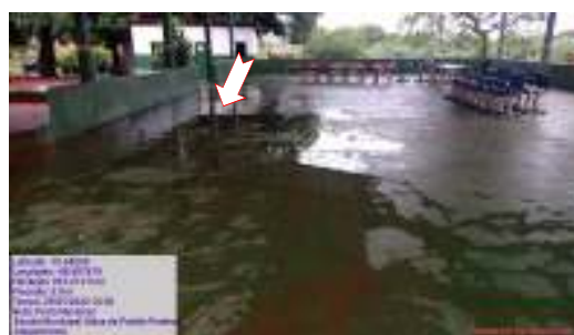
Figura 33 – Falha na drenagem.
