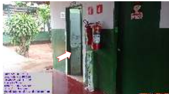
Figura 38 – ausência de sanitário para PNE.
