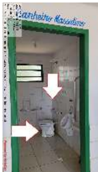
Figura 10 - Vaso sanitário e porta de acesso ao banheiro masculino inadequados às normas de acessibilidade.
