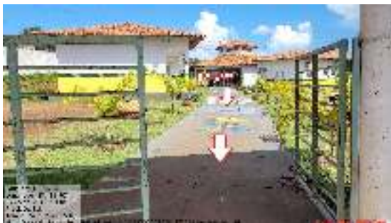
Figura 05 - Falta a instalação de piso tátil nos acessos internos da escola.
