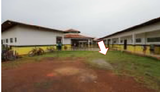
Figura 17 – Acúmulo de água no terreno.
