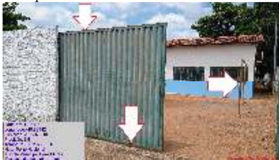
Figura 30 - Portão de acesso de veículo e traves de futebol oxidados (enferrujados) e com pinturas ruins.
