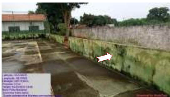
Figura 34 – Mureta com fissura.
