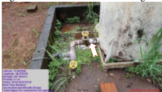
Figura 12 – Vazamento na caixa d'água.
