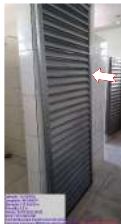
Figura 33 – Porta sem fechadura e oxidada.
