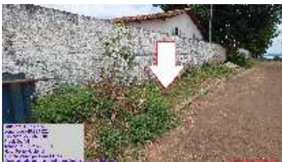
Figura 51 - Falta de calçada no entorno da escola.
