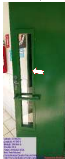
Figura 06 – Porta com vidro quebrado.
