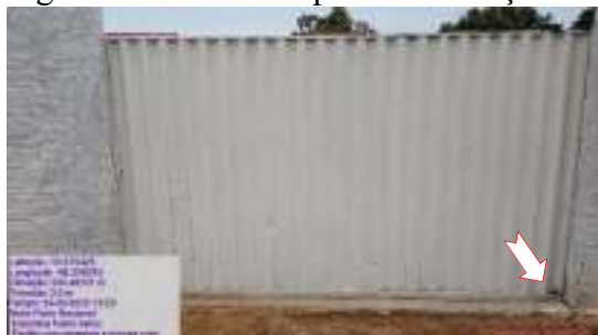
Figura 06 – Portão exposto a oxidação.
