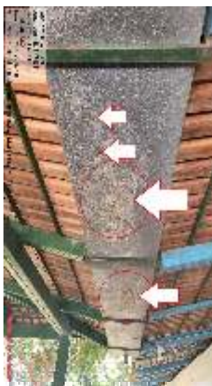
Figura 05 - Vazamento na calha metálica.
