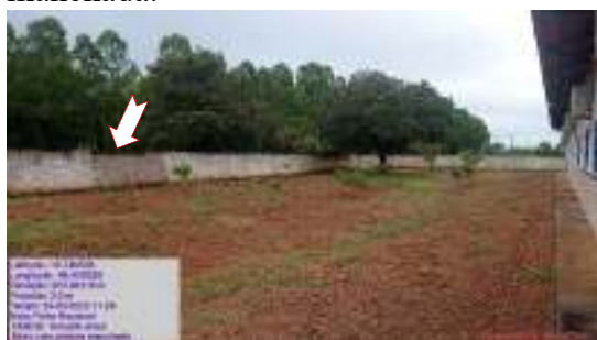
Figura 01 – Muro com a pintura manchada.
