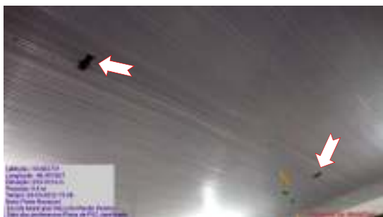
Figura 36 – Forro, placa PVC danificada.
