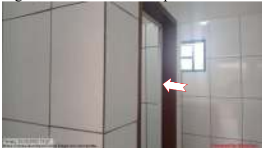
Figura 04 – Ausência de porta.
