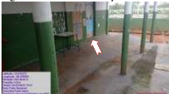
Figura 43 – Desnível entre pisos.
