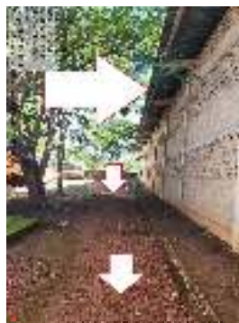
Figura 21 - Detalhe do beiral da cobertura do galpão vizinho que despeja águas da chuva no terreno da escola.
