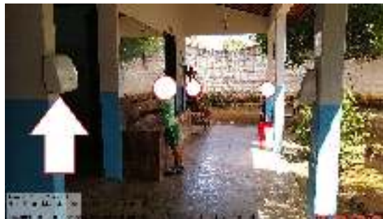
Figura 39 - Lavatório dos banheiros sem papel toalha no compartimento.
