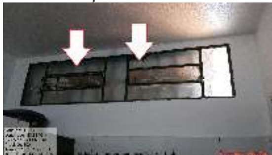
Figura 19 - Janela metálica do banheiro com dificuldade de abertura e obstrução de sua ventilação.
