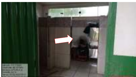
Figura 11 – Anexo - Utilização do banheiro PNE como depósito.
