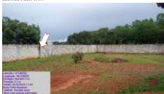
Figura 02 – Muro com a pintura manchada.
