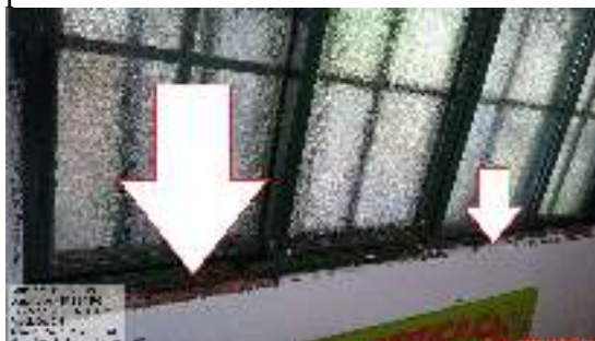
Figura 18 - Janela metálica com oxidação (ferrugem) na sua estrutura e com uma pintura ruim.
