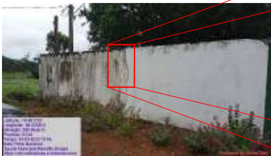
Figura 44 – Muro com rachadura e possibilidade de ruína.
