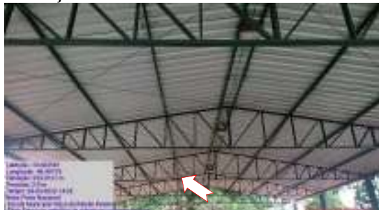
Figura 04 – Estrutura do Telhado com oxidação.
