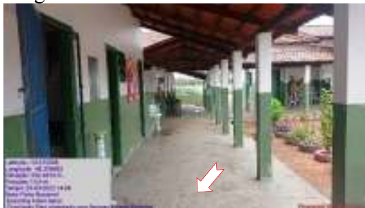
Figura 39 - Piso cimentado com fissuras e irregularidade.
