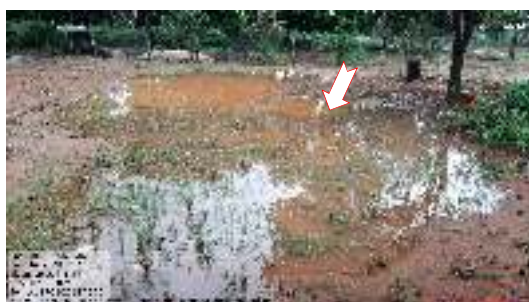
Figura 32 – Falha na drenagem.
