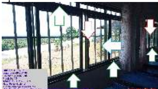
Figura 17 - Janela da sala de aula com fecho danificado, oxidada, vidro quebrado e pintura ruim.
