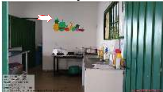
Figura 59 - Paredes da cozinha sem acabamento liso, impermeável e lavável.
