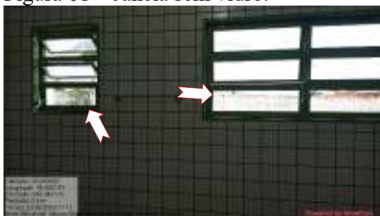
Figura 01 – Janela sem vidro.
