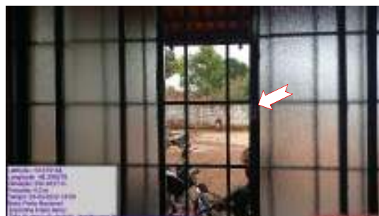
Figura 05 – Janela com fecho danificado.
