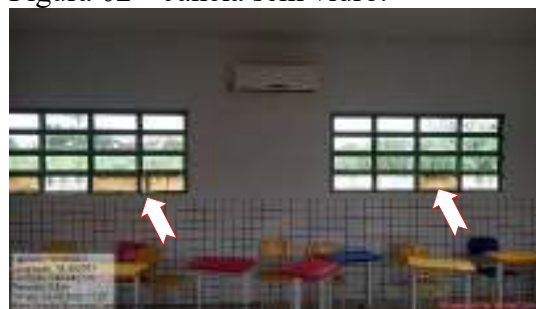
Figura 02 – Janela sem vidro.
