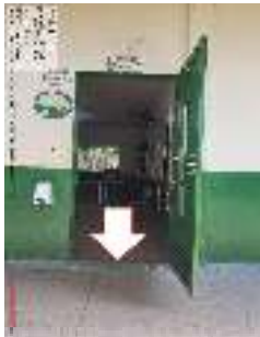
Figura 33 - Desníveis acentuados nos acessos às salas de aula.
