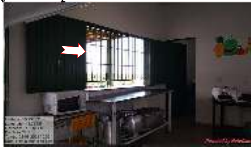
Figura 58 - Falta de tela milimétrica nas janelas e porta da cozinha.
