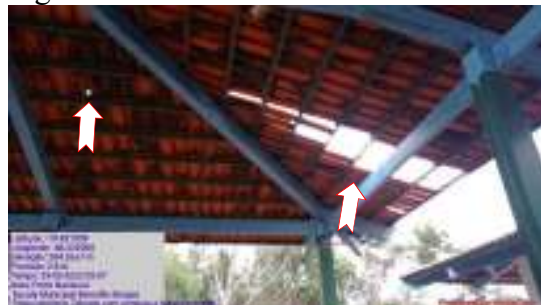
Figura 42 – Telhas danificadas e faltando.
