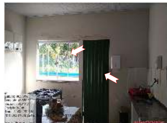
Figura 56 – Janela e porta da cozinha sem tela milimétrica.
