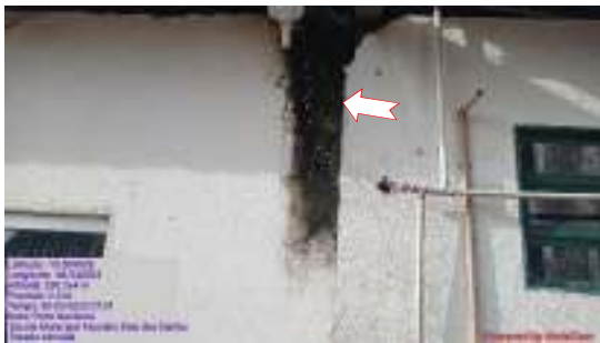
Figura 38 – Parede com mancha e indícios infiltração.
