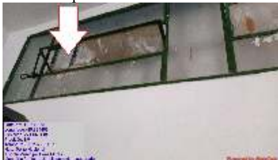
Figura 20 - Janela metálica do banheiro com vidro quebrado e pintura ruim sem a devida limpeza final.
