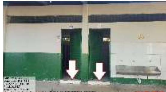
Figura 34 - Desníveis acentuados nos acessos aos banheiros.
