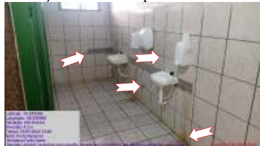
Figura 31 – Ausência de espelho, revestimento cerâmico danificado, higienização precária da cerâmica e tubulação sanitária exposta.
