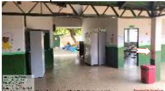
Figura 41 – Ausência de extintor de incêndio no pátio.
