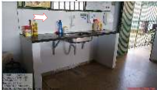
Figura 60 - Paredes da cozinha sem acabamento liso, impermeável e lavável.
