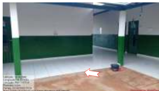
Figura 10 – Existência de desnível.
