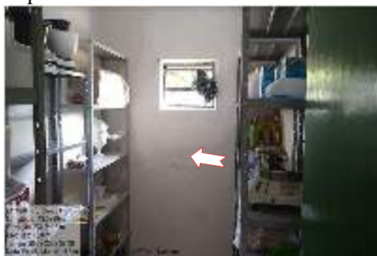
Figura 59 – Paredes do depósito de alimentos sem acabamento liso, impermeável e lavável.
