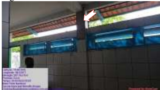
Figura 25 – Placa cerâmica faltando.
