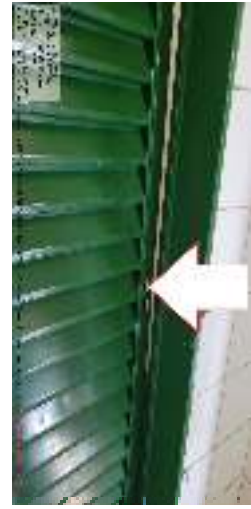
Figura 16 - Fechadura quebrada na porta metálica do banheiro feminino.
