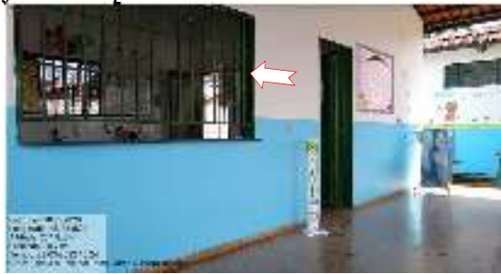
Figura 57 - Falta de tela milimétrica nas janelas e porta da cozinha.
