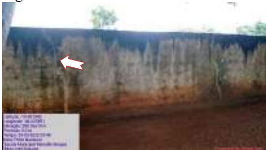
Figura 45 – Muro com fissura.
