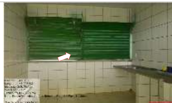
Figura 52- Janelas da cozinha sem telas milimétricas.
