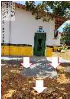
Figura 13 - Falta corrimão na rampa de acesso à sala de aula 03.
