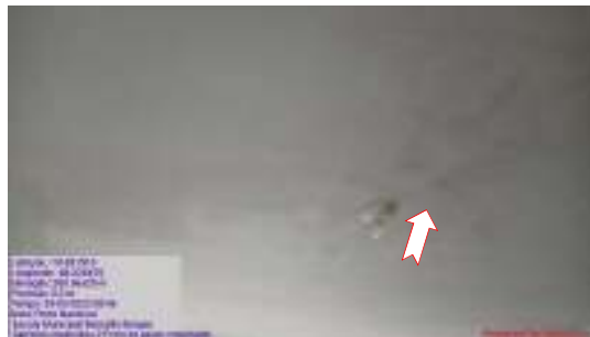
Figura 28 – Forro com mancha.
