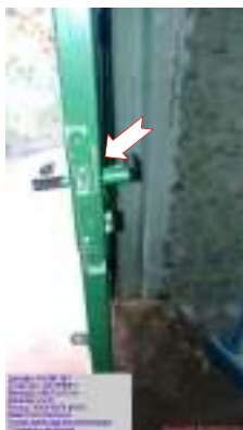
Figura 23 – Porta com fechadura danificada.
