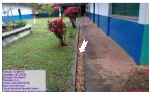
Figura 31 – Canaletas sem proteção.
