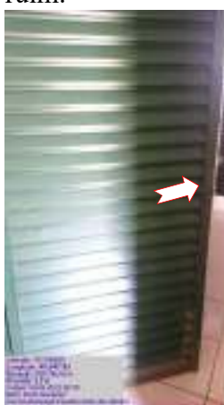
Figura 34 – Porta com fechadura danificada e pintura ruim.
