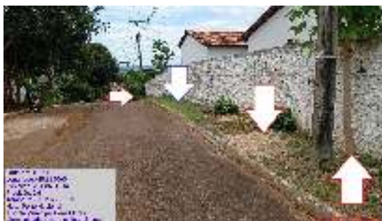
Figura 52 - Falta de calçada no entorno da escola.
