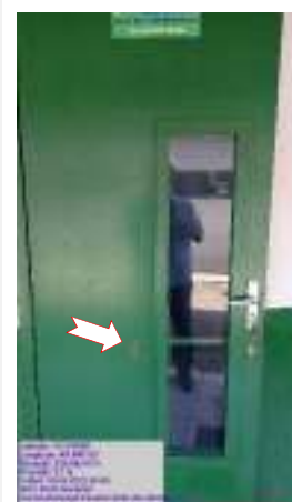
Figura 35 – Porta danificada e pintura ruim.
