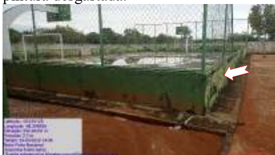
Figura 36 – Mureta com infiltração e pintura desgastada.
