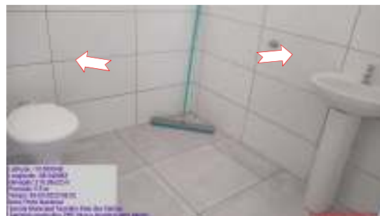
Figura 51 – Sanitário destinado a PNE sem Barras.
