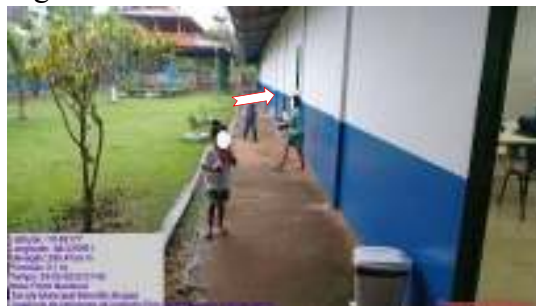
Figura 48 – Ausência de extintor.
