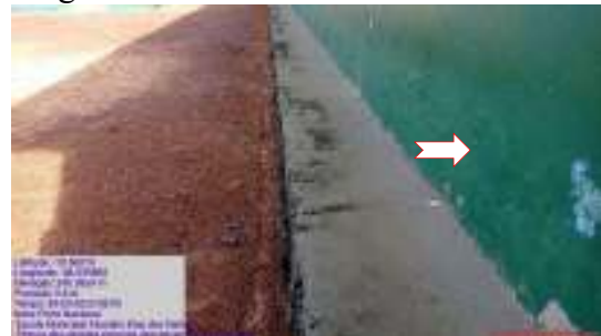
Figura 27 – Parede com pintura desgastada.
