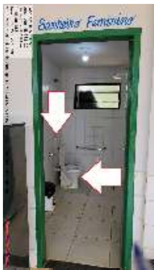
Figura 09 - Vaso sanitário e porta de acesso ao banheiro feminino inadequados às normas de acessibilidade.
