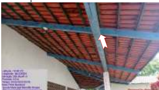
Figura 06 – Estrutura do Telhado exposto a oxidação.
