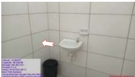
Figura 50 – Sanitário destinado a PNE sem Barras.
