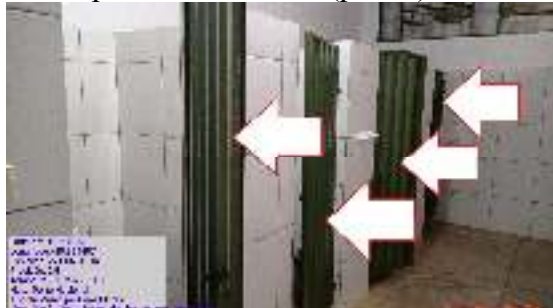
Figura 36 - Má qualidade da pintura à óleo nas esquadrias metálicas (portas).
