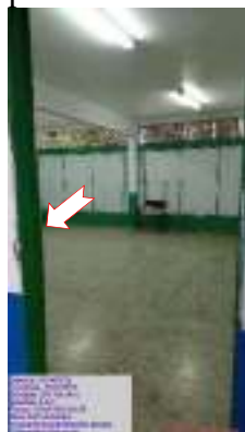
Figura 22 – Ausência de porta.
