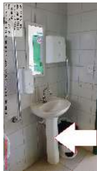
Figura 11 - Lavatório inadequado às normas de acessibilidade.
