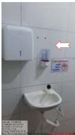
Figura 35 – ausência de espelho.
