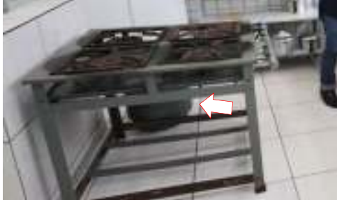
Figura 23-Botijão de gás acondicionado dentro da cozinha. (sede)
