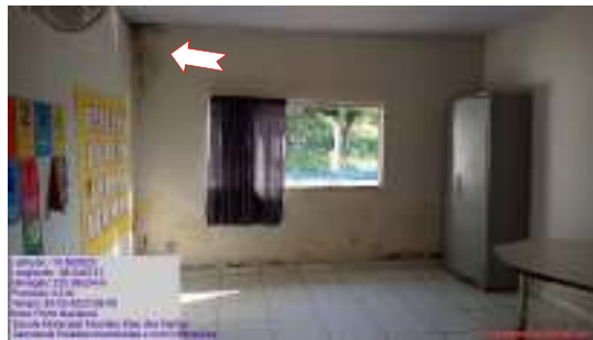
Figura 39 – Parede com mancha e indícios infiltração.
