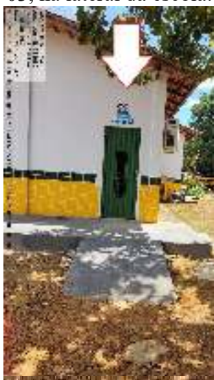
Figura 02 - Falta de cobertura de acesso à sala de aula 03, na lateral da escola.
