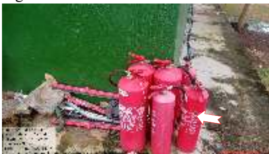
Figura 08 – Extintores com data vencida.
