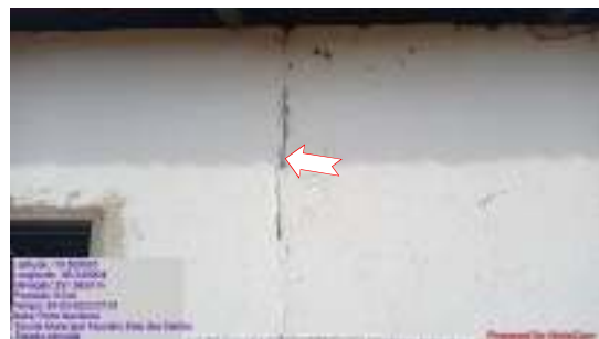
Figura 14 – Parede com fissura.
