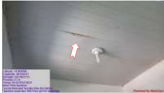
Figura 37 – Forro com mancha e indícios infiltração.
