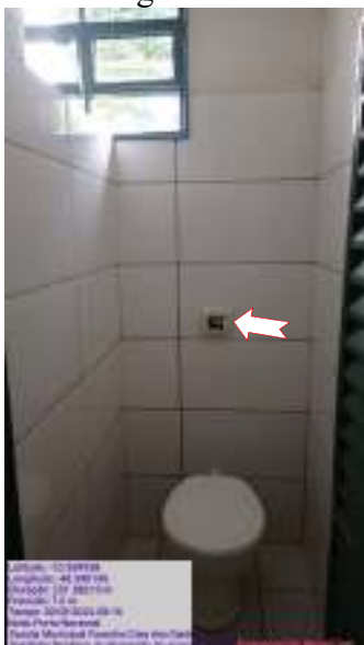
Figura 43 – Ausência de acabamento no acionador de descarga.
