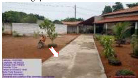
Figura 02 - Falta cobertura na passarela de interligação entre os edifícios.
