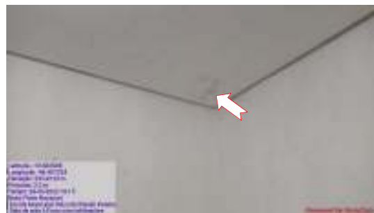
Figura 28 – Forro com indícios de infiltração.
