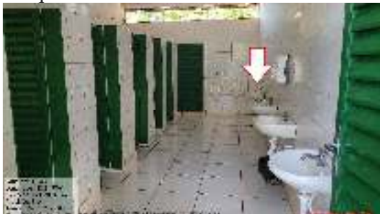
Figura 35 - Banheiro masculino sem barras de apoio no lavatório.
