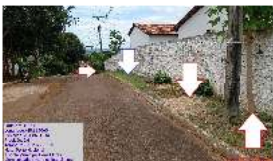
Figura 44 - Matos e entulhos no acesso lateral da escola.
