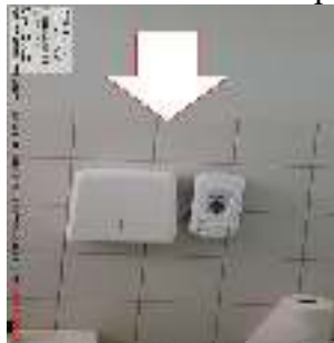
Figura 26 - Banheiro masculino administrativo sem espelho.
