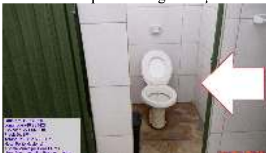
Figura 26 - Falta de porta metálica no box do banheiro e precária higienização.
