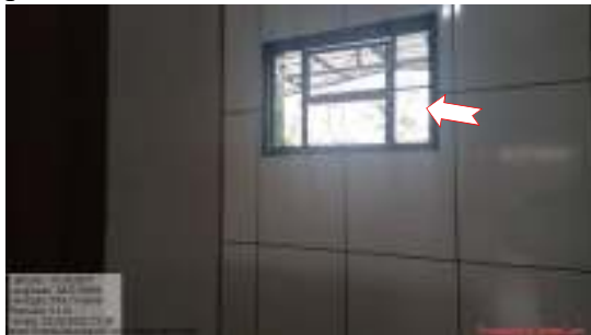
Figura 02 – Janela sem vidro e sem pintura.
