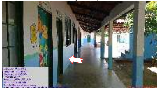
Figura 42 – Ausência de extintor de incêndio no acesso principal.
