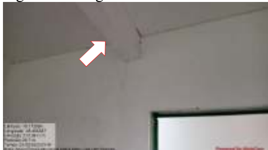
Figura 02 – Viga com fissura.
