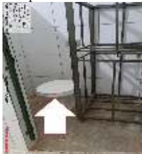
Figura 54 - Banheiro sem vaso sanitário adequado à PNEs.
