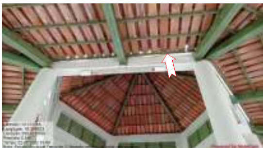
Figura 16 – Telha mal instalada.
