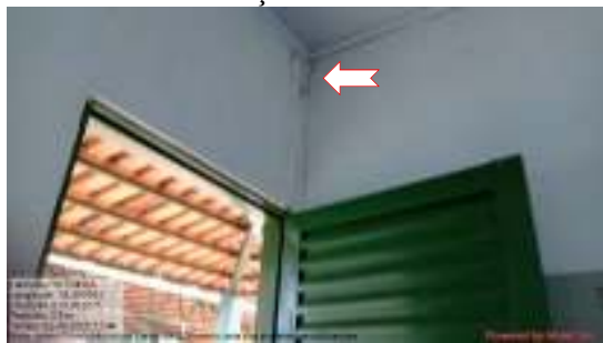
Figura 04 – Anexo - Pintura e forro com indício de infiltração.
