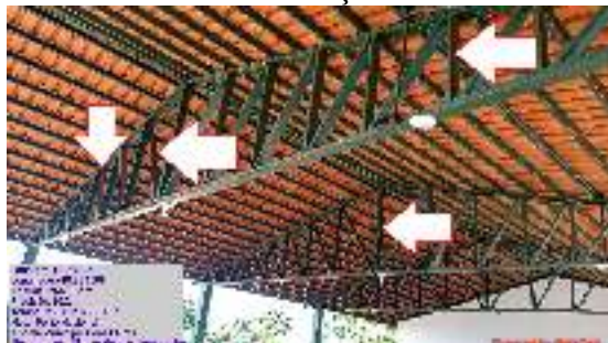
Figura 03 - Oxidação das peças metálicas da estrutura de sustentação do telhado.
