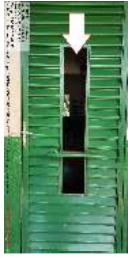
Figura 15 - Falta vidro na porta metálica de acesso à sala de aula do 7º ano.
