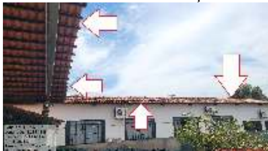
Figura 01 - Telhado com deformações na estrutura metálica e falta emboçamentos.
