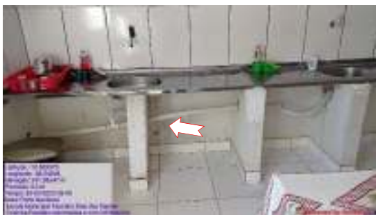
Figura 40 – Parede com mancha e indícios infiltração.
