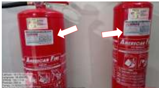
Figura 10 – Extintor com data de validade vencida.
