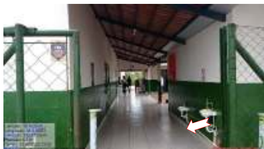
Figura 09 – Ausência de piso tátil.
