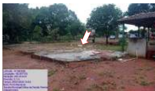
Figura 31 – Falha na drenagem.
