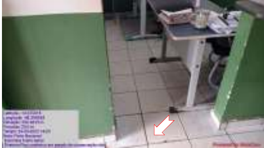
Figura 40 - Piso revestimento cerâmico trincado.
