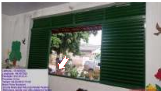
Figura 01 – Janela com dificuldade de fechar.
