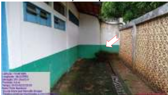
Figura 17 – Pintura desgastada e com indicio de infiltração na parede.
