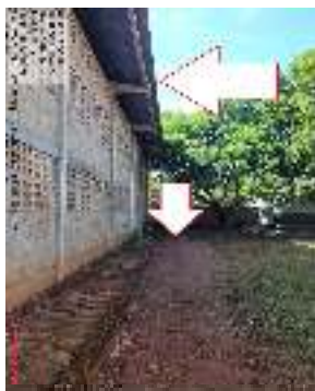
Figura 20 - Detalhe do beiral da cobertura do galpão vizinho que despeja águas da chuva no terreno da escola.
