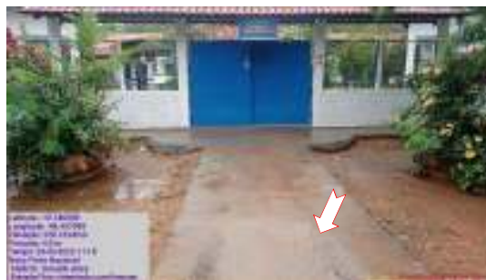
Figura 04 – Ausência de piso tátil.
