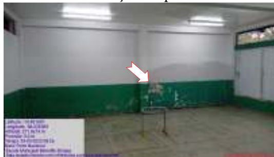
Figura 18 – Pintura desgastada e com indicio de infiltração na parede.
