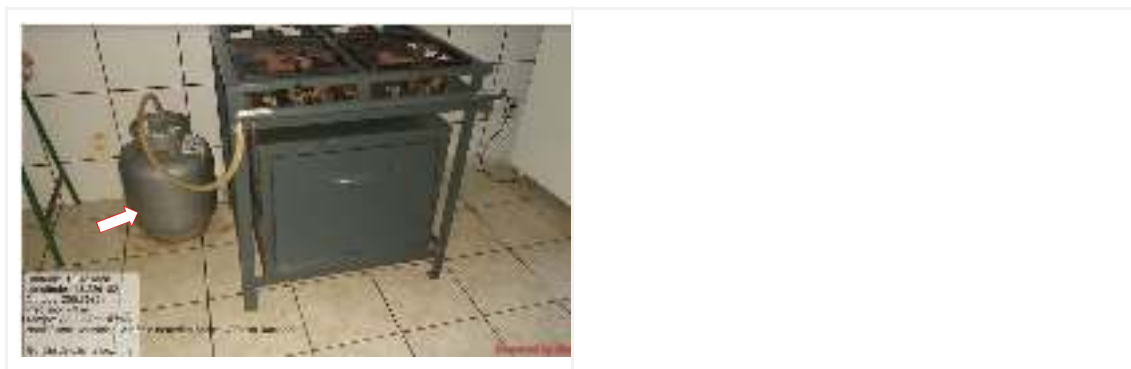
Figura 50- Botijão de gás acondicionado dentro da cozinha.
