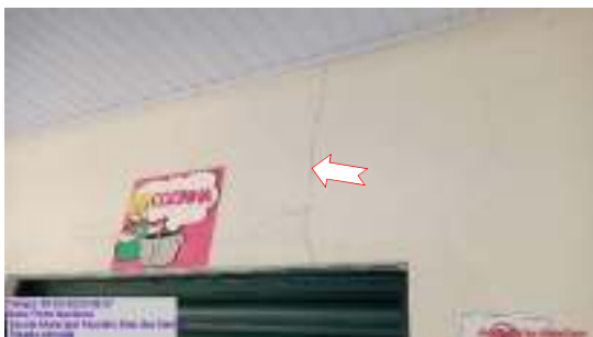
Figura 13 – Parede com fissura.
