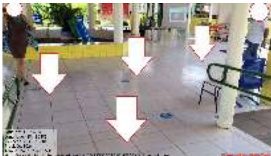
Figura 06 - Falta a instalação de piso tátil nos acessos internos da escola.
