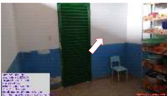
Figura 55 – Paredes do depósito de alimentos sem acabamento.
